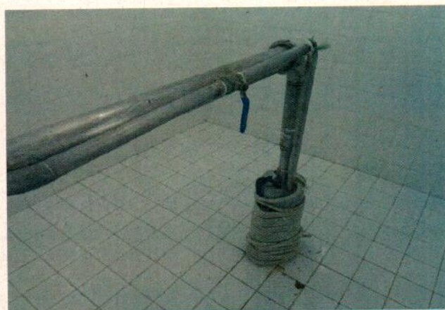
Captação da Fonte
